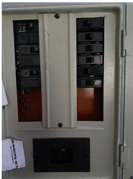
Figura 1 – Fotel do QGBT1 localizado na sala na sala do Plenário.
