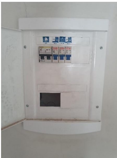
Figura 3 – Foto do QGBT-3 localizado no corredor de acesso à cozinha.
