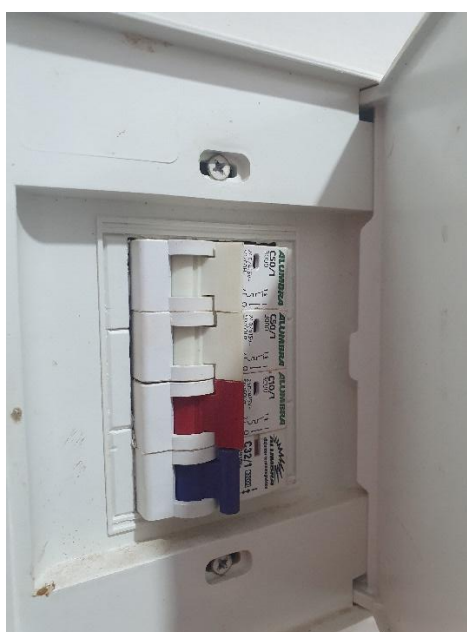
Figura 2 – Foto do QGBT-2 localizado na sala Administrativa
